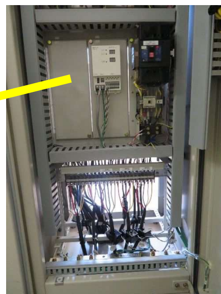
空きスペースへの設置例
